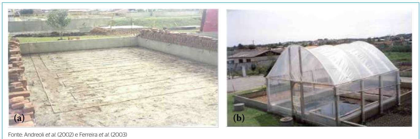
Figura 6 - Leito de secagem convencional modificado para promover a secagem e higienização do lodo de forma simultânea: (a) tubulação de cobre colocada na camada drenante de um leito de secagem para a circulação do óleo aquecido; (b) cobertura do leito de secagem modificado com estufa plástica
