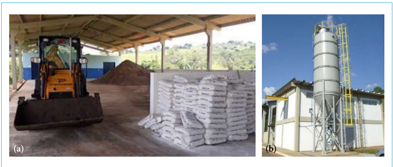
Figura 2 – Armazenamento da cal virgem: (a) para ETEs de pequeno porte, em sacos de 20 kg; (b) para ETEs de grande e médio porte são empregados silos.
