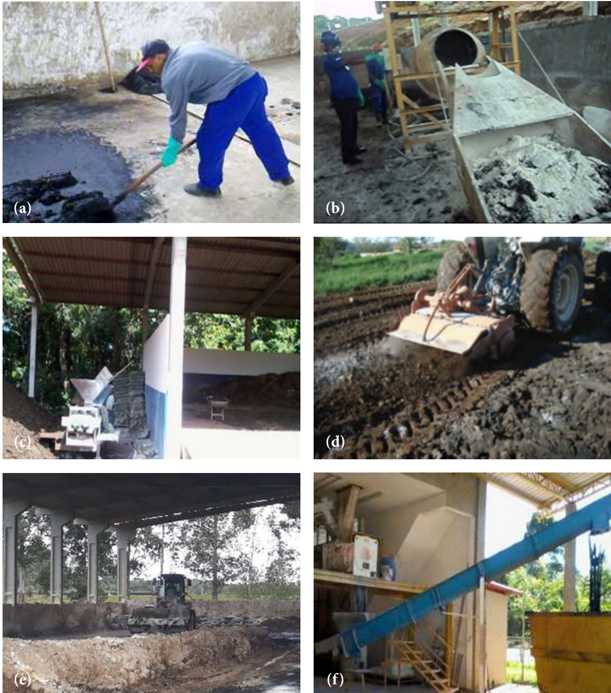
Figura 3 – Alternativas de homogeneização do lodo com a cal: (a) manual; (b) betoneira; (c) maromba; (d) enxada rotativa; (e) retroescavadeira; (f) misturador mecânico horizontal (eixo central e pás do tipo arado com tempo de detenção mínimo de 3 minutos).
