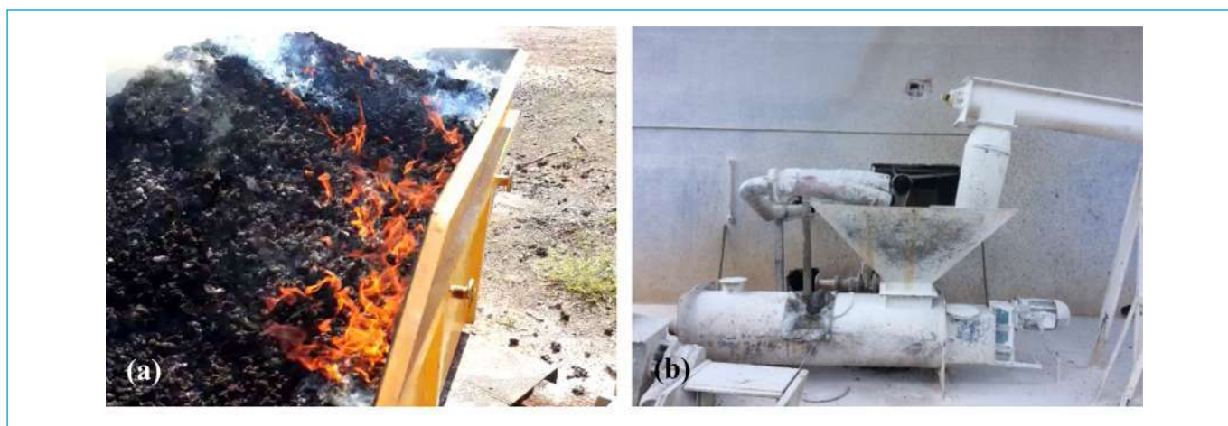
Figura 6 – Problemas encontrados durante o processo de EA: (a) combustão do lodo misturado com a cal e (b) elevada liberação de poeiras.
